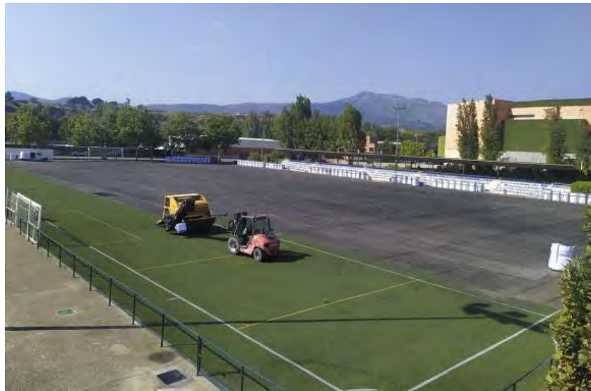
Inicio de las obras del campo de fútbol 11 de Arnedo. Así se mostraba ayer el campo. / B. M.
