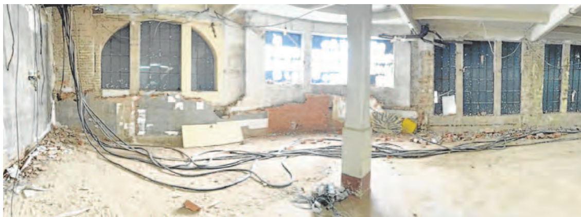
Aspecto de la primera planta una vez desmantelados los puestos y descubiertas las cristalerías que serán renovadas para devolver la luz natural. L. R.
